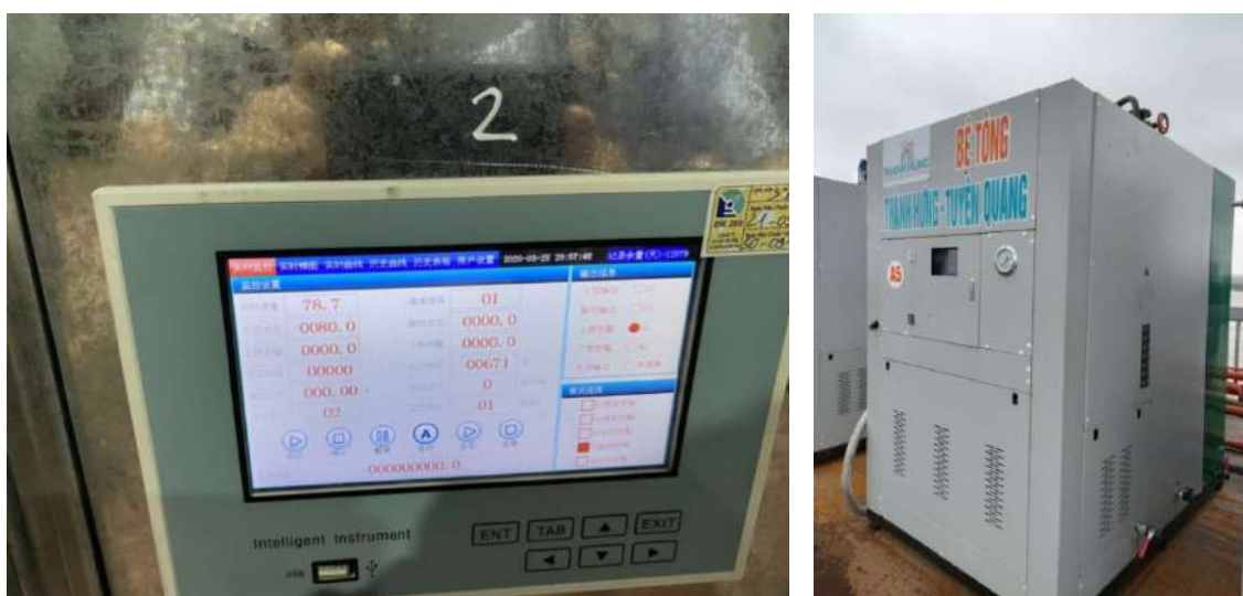
Hình 16. Hệ thống xử lý nhiệt được sử dụng trong dự án "sửa chữa mặt cầu Thăng Long".
